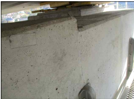
교각 코핑부 균열(P4)
