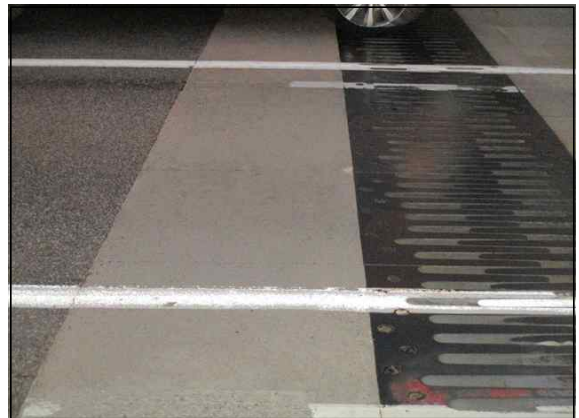
신축이음 후타재 균열(A2)
