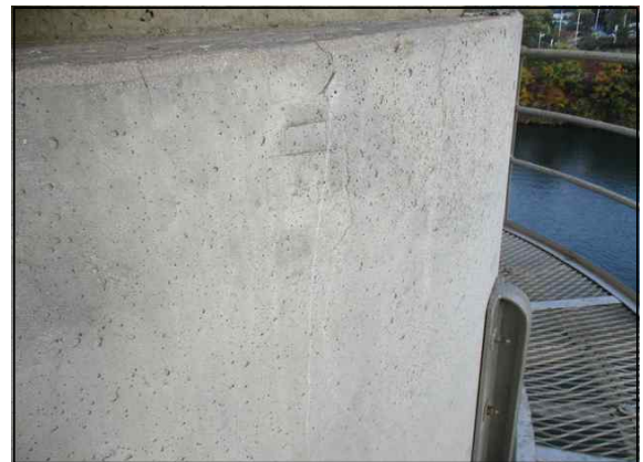
교각 기둥부 균열(P12)
