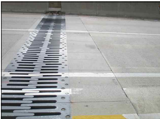
신축이음 후타재 균열(A1)
