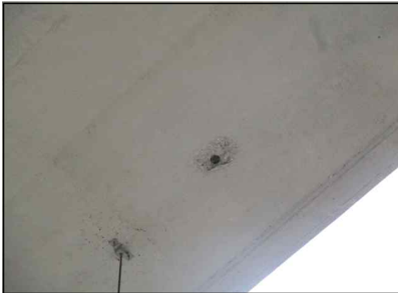
바닥판 콘크리트 파손(S7)
