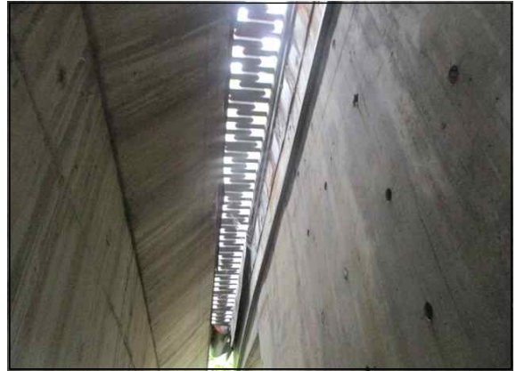
신축이음 물받이 파손(A2)
