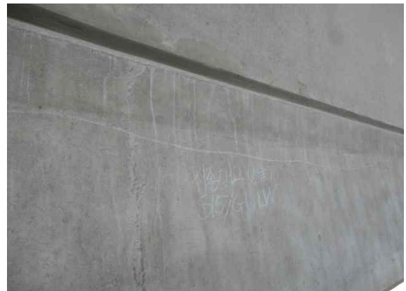
거더 외부 측면 균열(S15)
