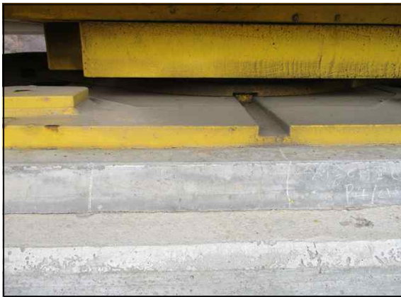
반침물탈 균열(P4 SH2)
