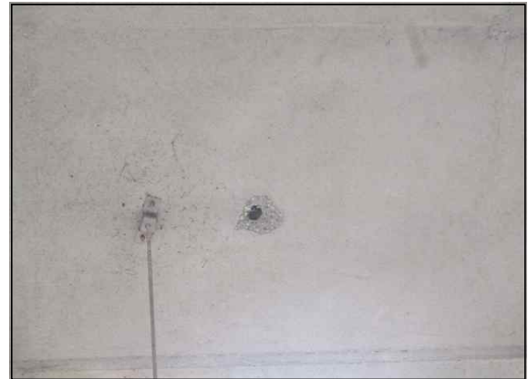
바닥판 콘크리트 파손(S8)
