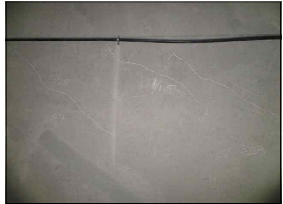
거더 내부 균열(S15)
