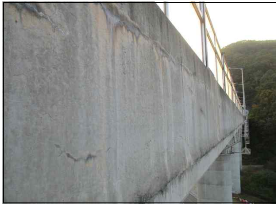
방호벽 균열부 백태(S3)
