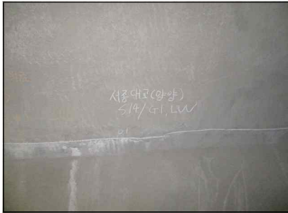
거더 내부 균열(S14)
