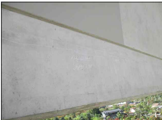
거더 외부 측면 균열(S6)
